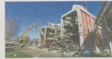
... ebenso wie dieser nicht mehr benötigte Kühlturm. FOTOS: BS ENERGY
